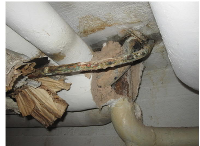
Rikkonaisista putkieristeistä voi vapautua asbestikuituja sisäilmaan
