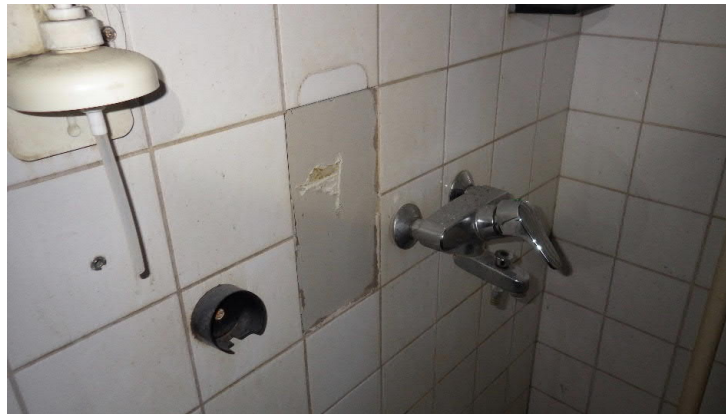
Asbestipitoista kuitusementtilevyä keraamisen laatoituksen ja muovitapetin taustalla
