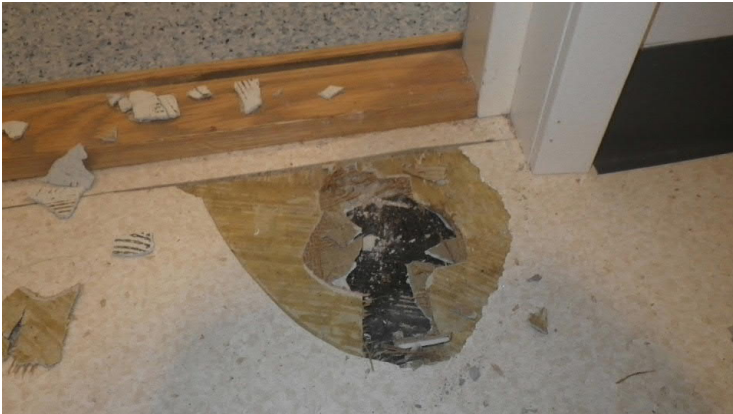
Asbestipitoinen vinyylilaatoitus ja musta liima kahden muovimaton alla
