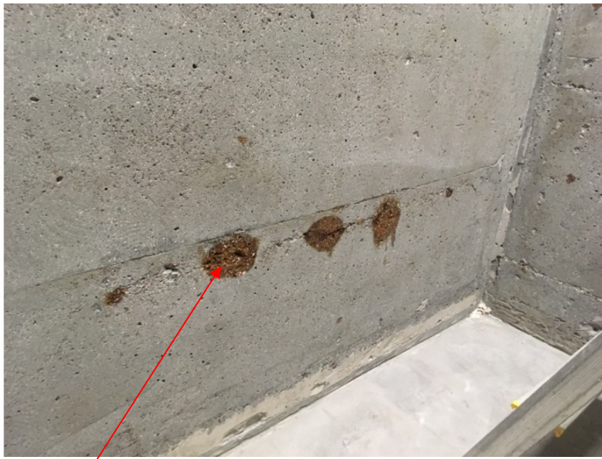
Raudoituksen korroosio tullut näkyviin betonin pintaan
