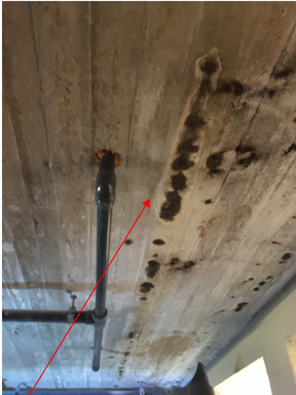
Raudoituksen ja betonin vaurio katossa
